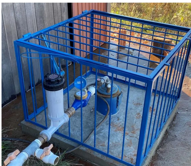
Figura 4. Modelo de proteção e cercamento do poço.
