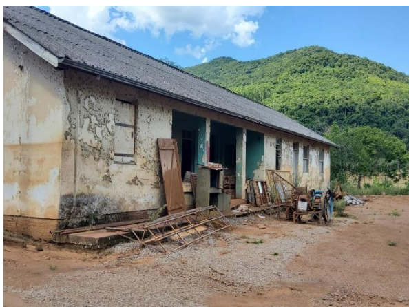
Figura 14- Evidências antigas e recentes (marcas d'água na ocupação) em escola antiga da comunidade Barra do Zeferino. Setor RS_DOUTORR_SR_013_SGB.
